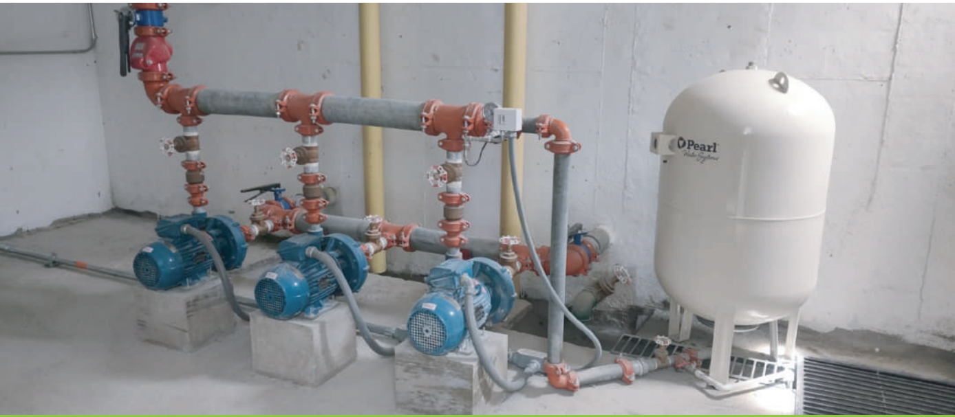
Sistema de recirculación de agua
